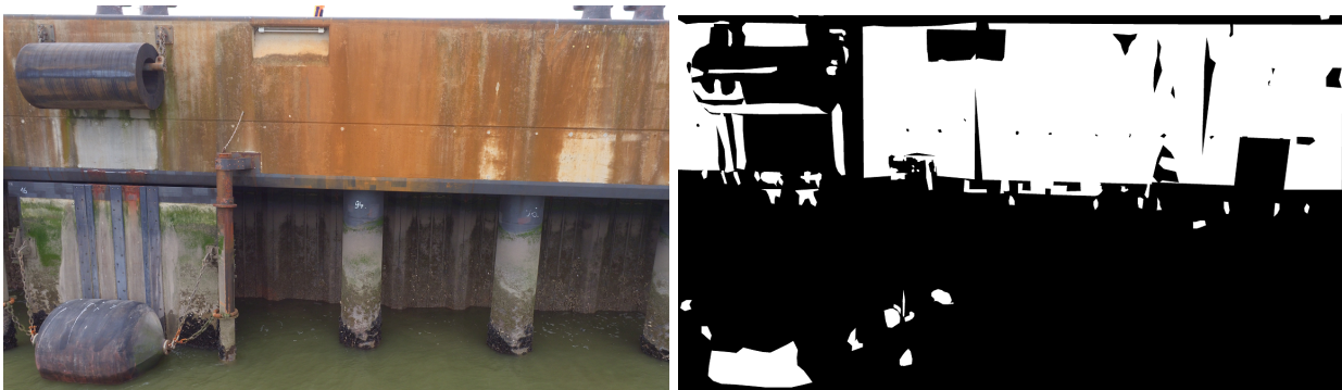
Abbildung 1.3: Ausgeschnittenes RGB-Bild (links) und erstelltes Labelbild (rechts) des Jade-Weser-Ports in Wilhelmshaven. Die Klassen unbeschädigt und Korrosion sind in Schwarz bzw. Weiß dargestellt (Hake et al., 2023b).
